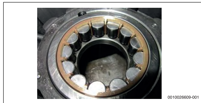
Рис. 74 Исправные подшипники компрессора
